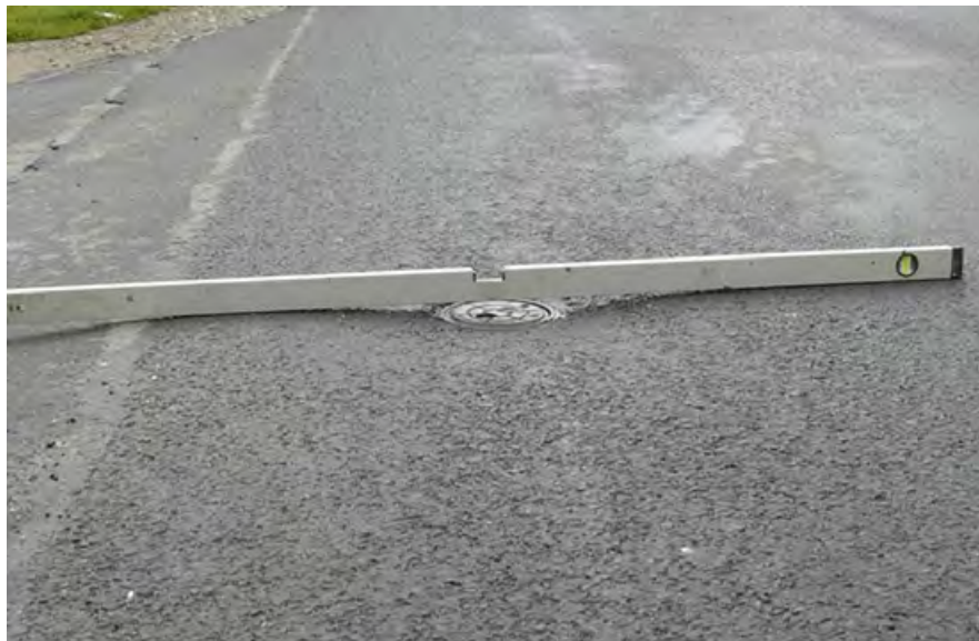
Fot.9 Dziesięcioletnia powierzchnia; ugięcie 5cm i brak pęknięć
