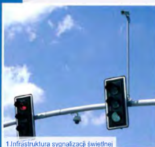
1. Infrastruktura sygnalizacji świetlnej
