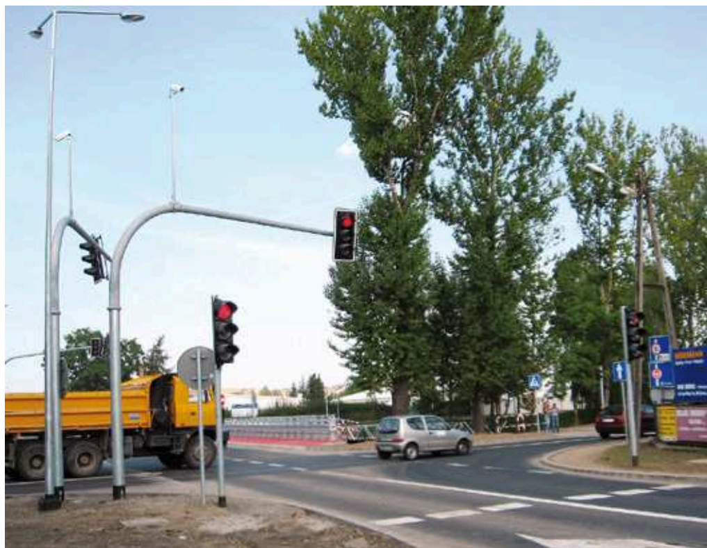
Kamery do wideodetekcji na skrzyżowaniu w Myślenicach w ciągu DK nr 7
