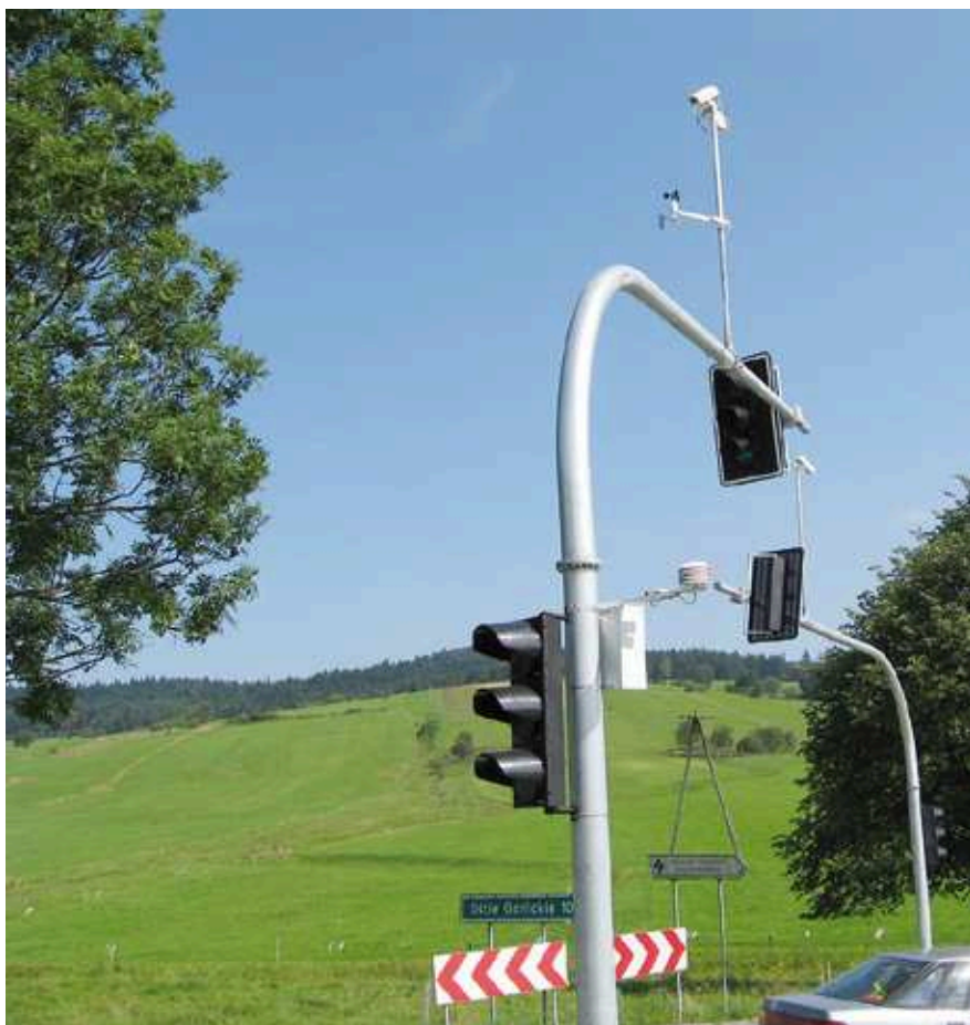
System wideodetekcji, monitoringu ze zdalnym zarządzaniem w Gładyszowie w ciągu DW nr 977
